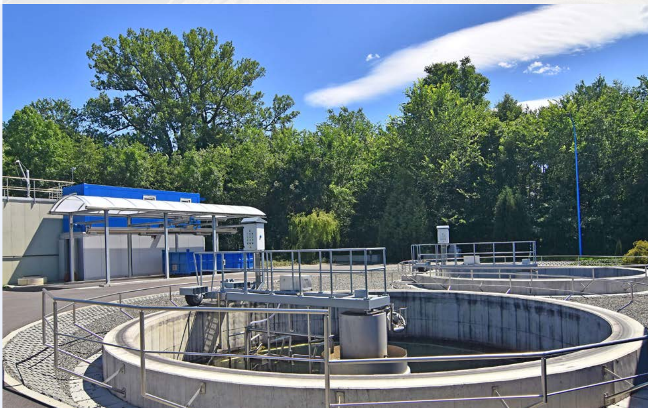
Čistírna odpadních vod Bílovec – Provoz byl v uplynulých letech za více než 60 miliónů zmodernizován a rozšířen. Nová kapacita 8 800 ekvivalentních obyvatel umožní napojování dalších domácností a rozvoj Bílovce a Velkých Albrechtic.
