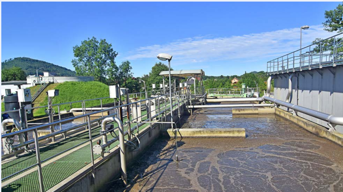
Čistírna odpadních vod Kopřivnice – V areálu byla v uplynulých letech vybudována nová dosazovací nádrž za 38 milionů korun. To má pozitivní dopad na kvalitativní parametry vyčištěné vody. Díky investici se budou moci připojit noví odběratelé v okrajových částech města, kde je vybudována kanalizační síť (Mniší, Vlčovice).
